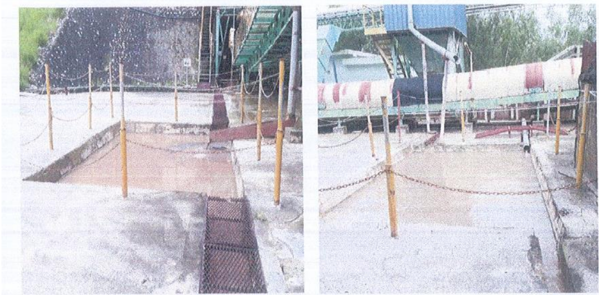
Hình 3.9. Hình ảnh bể công trình bể lắng 03-BC101 và 03BC102
