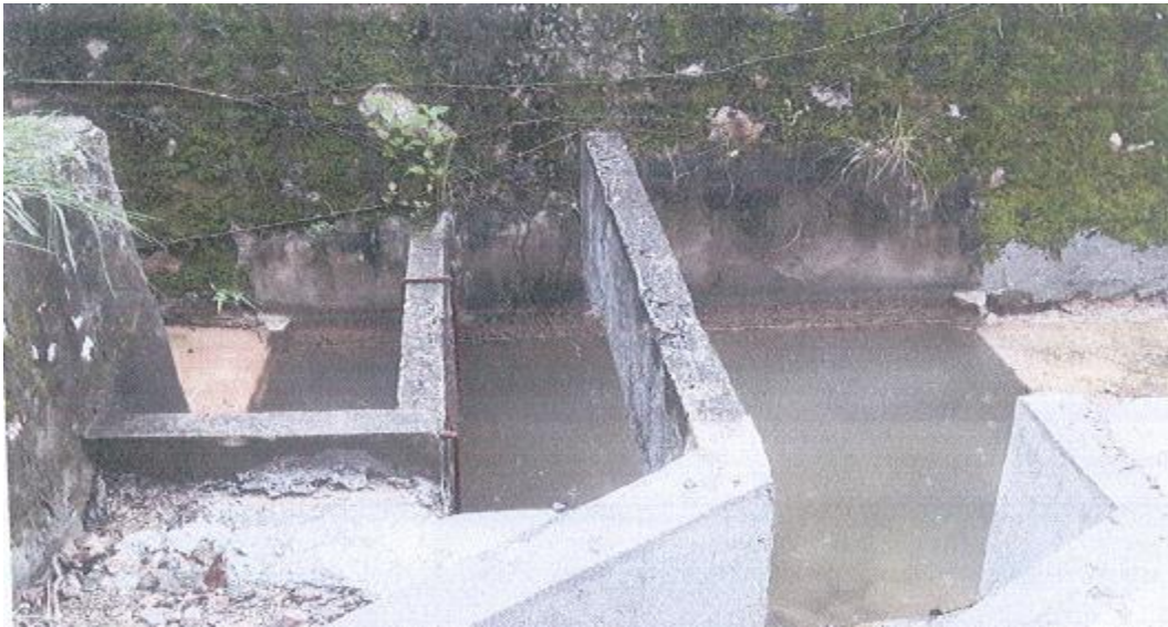
Hình 3.7. Hình ảnh bể bẫy dầu khu vực xưởng sửa chữa
