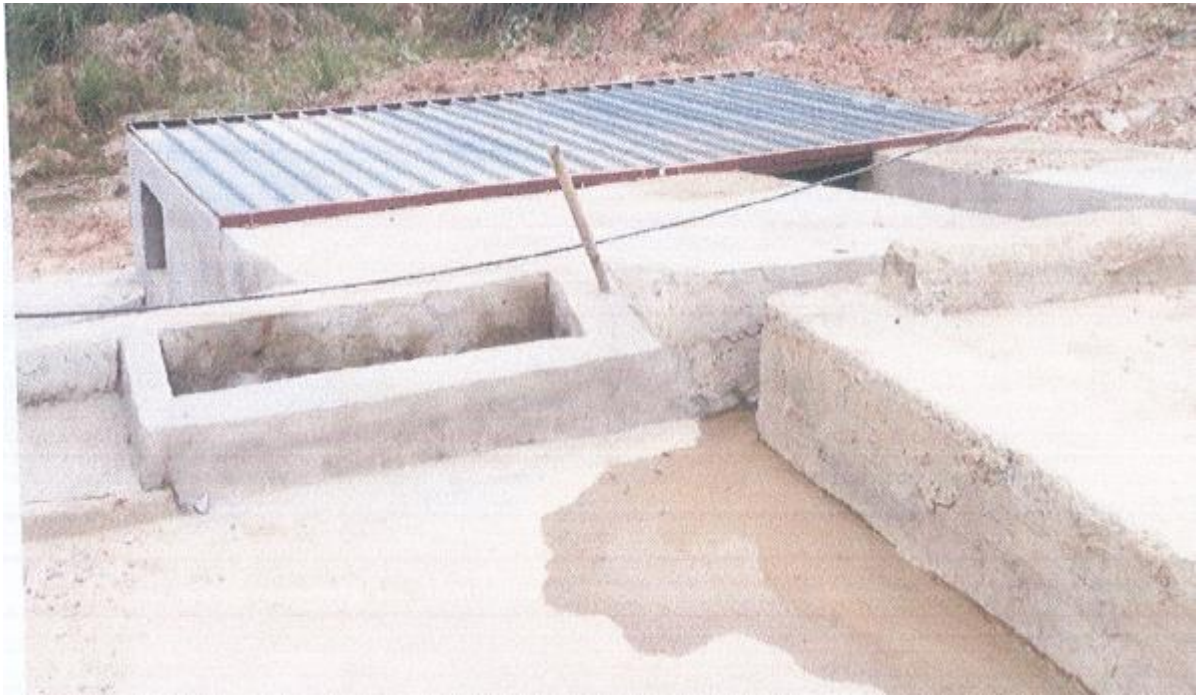
Hình 3.8. Hình ảnh bể tách dầu khu vực rửa xe
