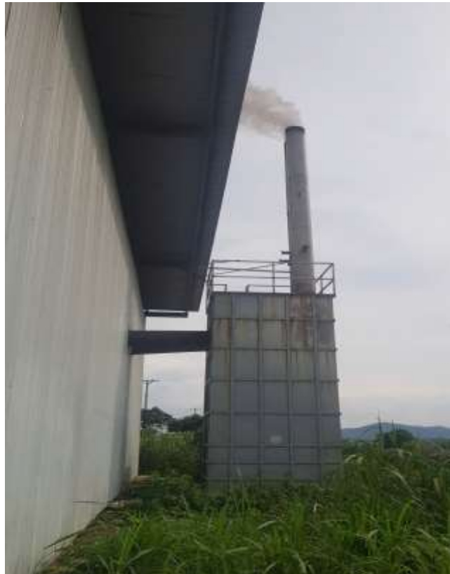
Hình 3. 15. Hình ảnh hệ thống xử lý khí lò thiêu hủy gia súc
