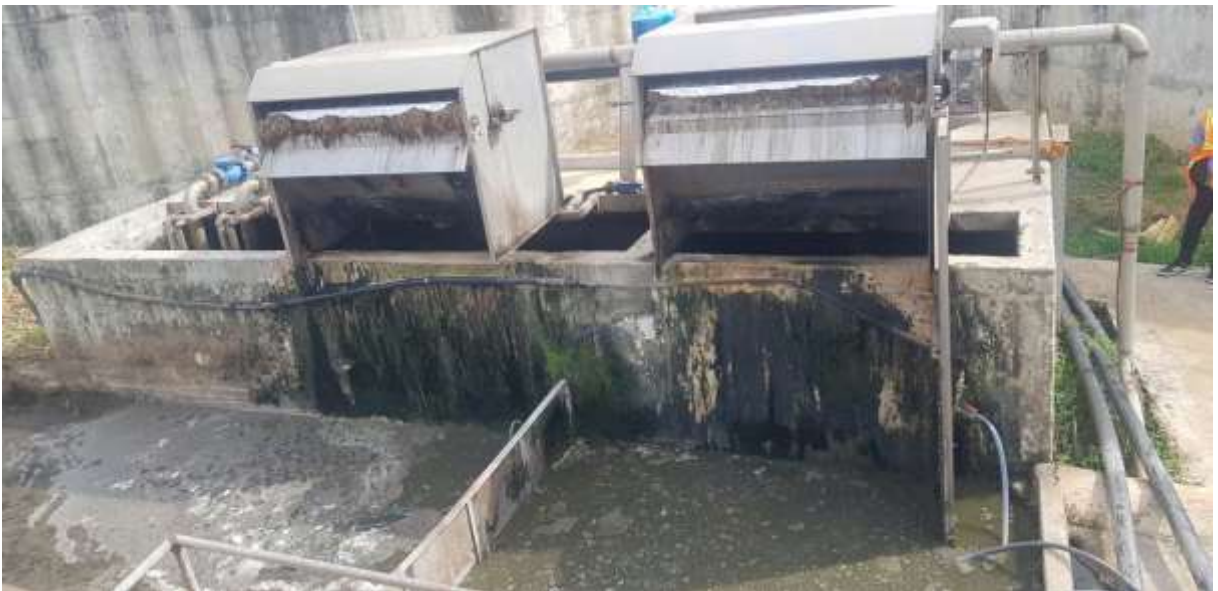
Hình 3. 6. Hệ thống máy tách phân
