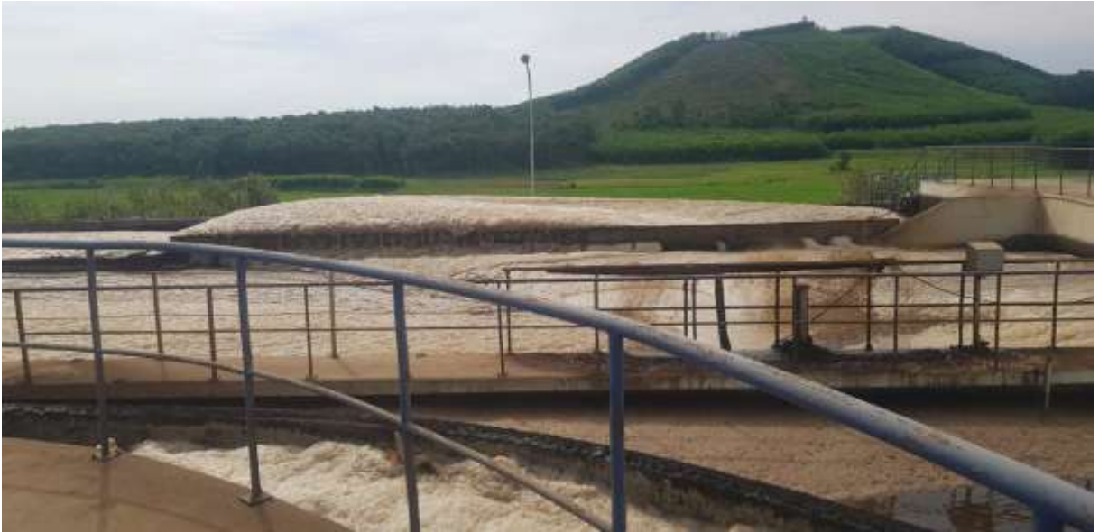
Hình 3. 11. Hình ảnh bể keo tụ, tạo bông
