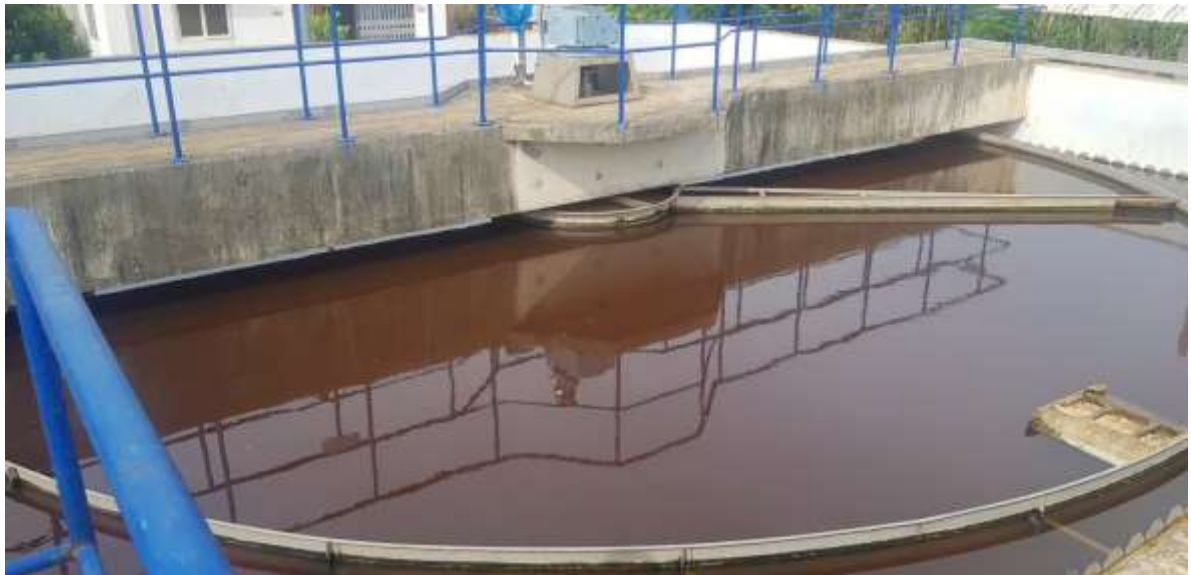
Hình 3. 12. Hình ảnh bể lắng sinh học
