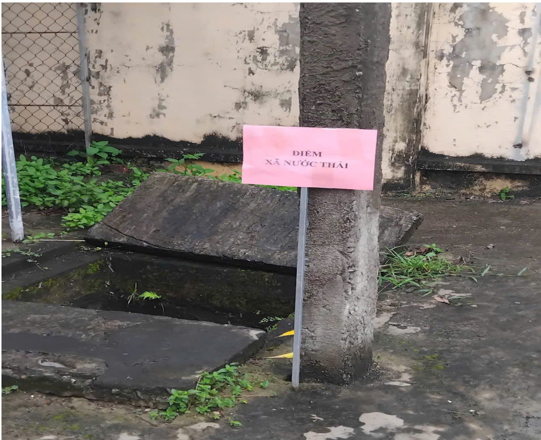
Hình 3. 2: Vị trí hố ga xả thải nước thải vào mương thoát nước khu vực 1.2.3. Sơ đồ mạng lưới thu gom, thoát nước thải
