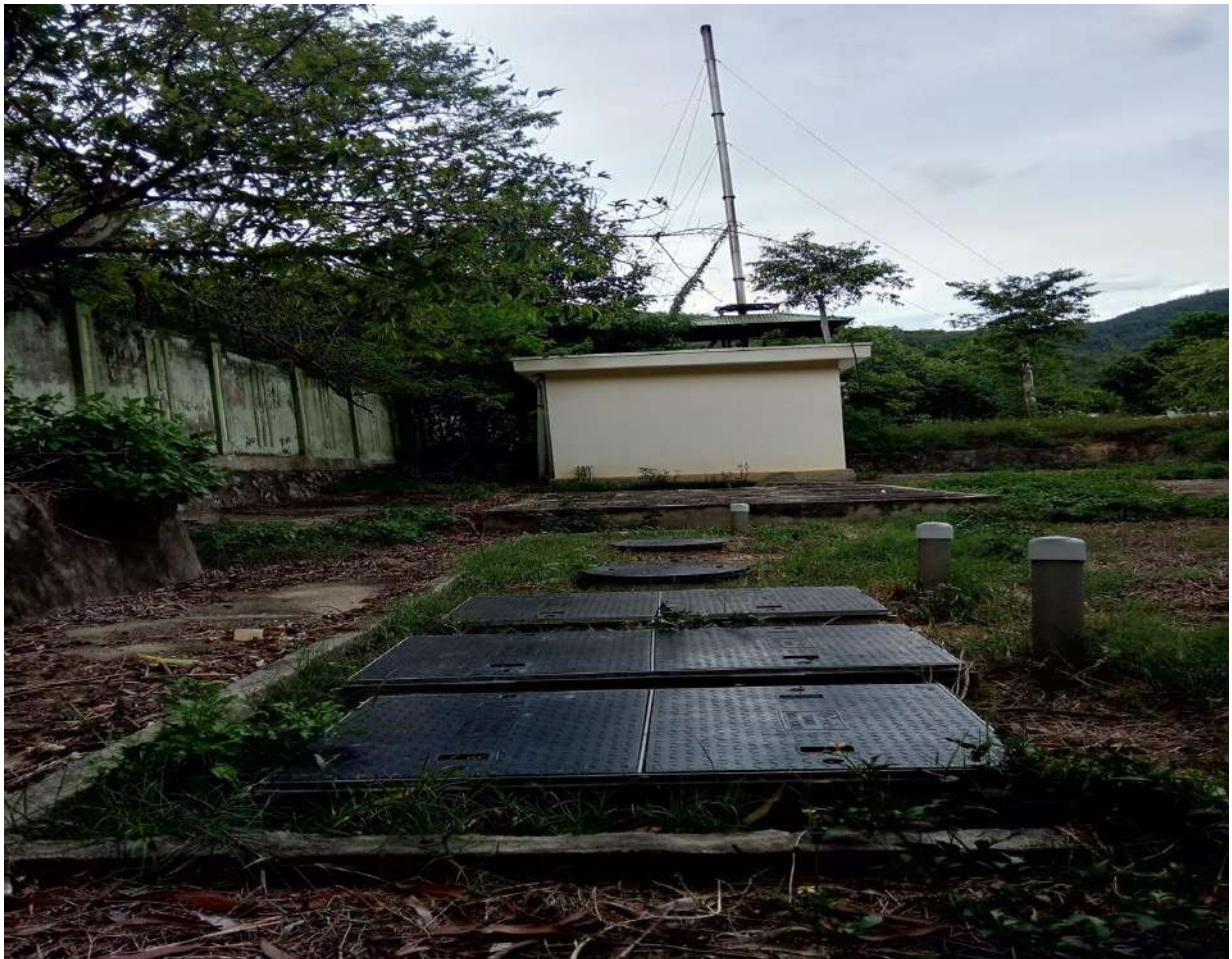
Hình 3.4. Khu vực các bể xử lý nước thải của cơ sở
