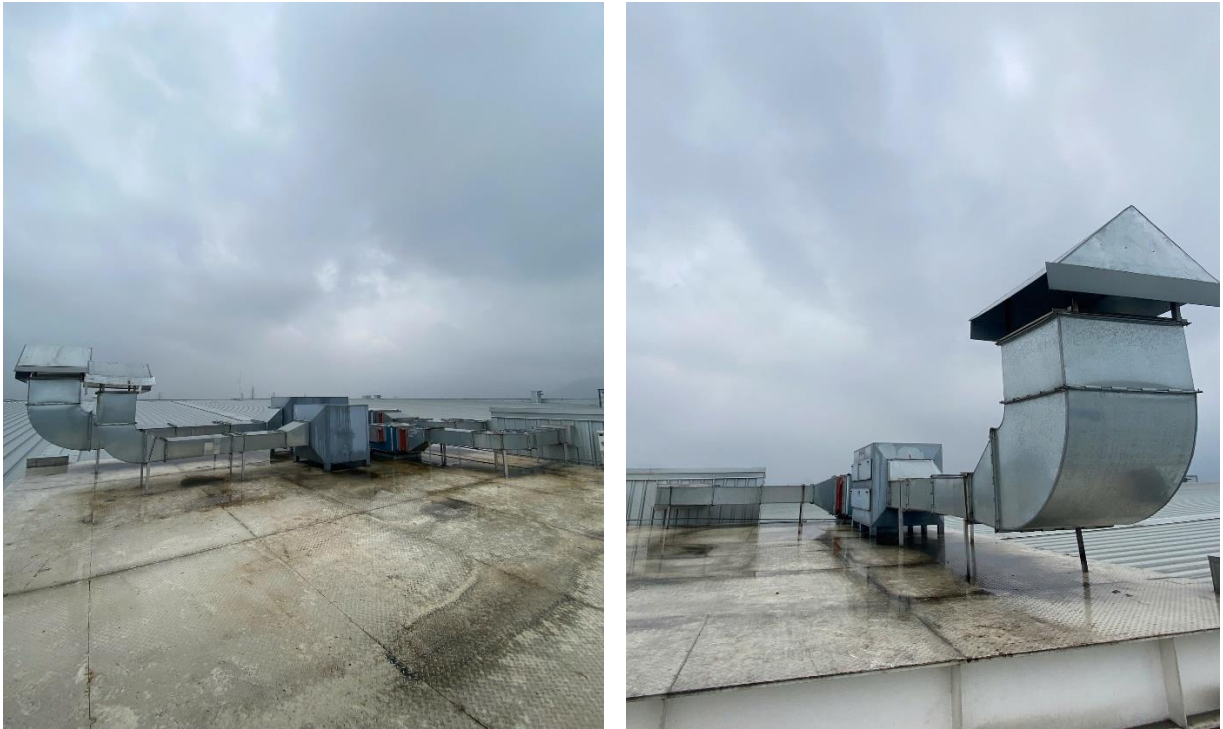
Hình 19: Hệ thống xử lý và xả khí thải của dự án
