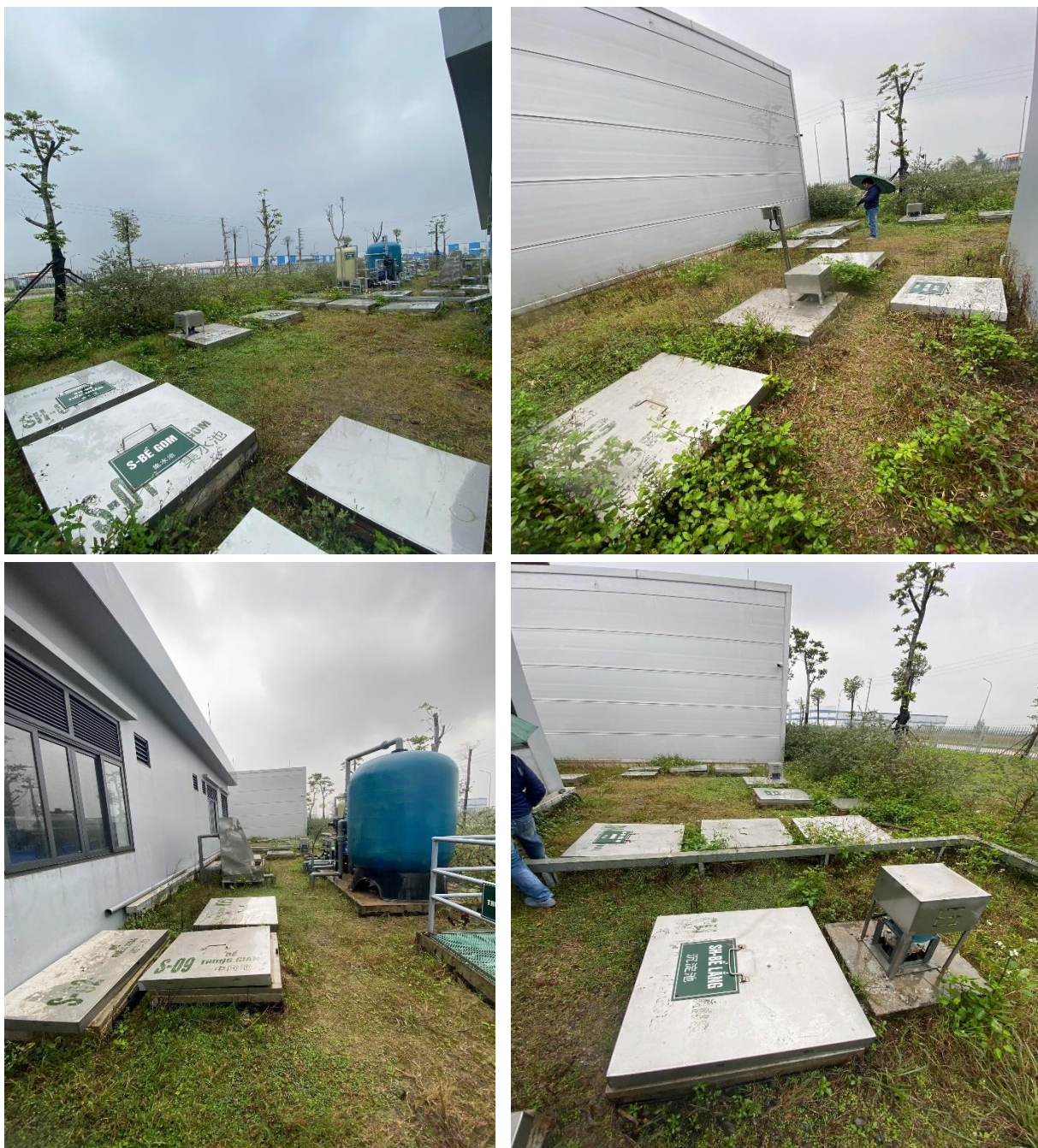
Hình 13: Hình ảnh hệ thống xử lý nước thải sản xuất + sinh hoạt của dự án
