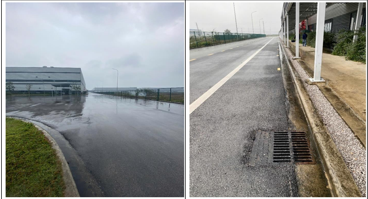
Hình 6: Hệ thống thu gom nước mưa
