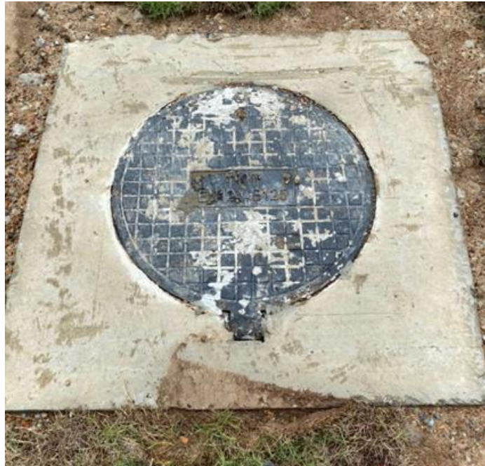
Hình 3.6. Hố gas thu gom nước thải tại dự án
