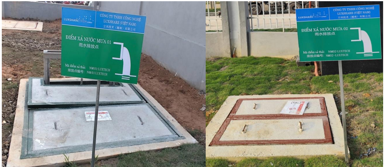
Điểm đầu nối xả nước mưa số 1
