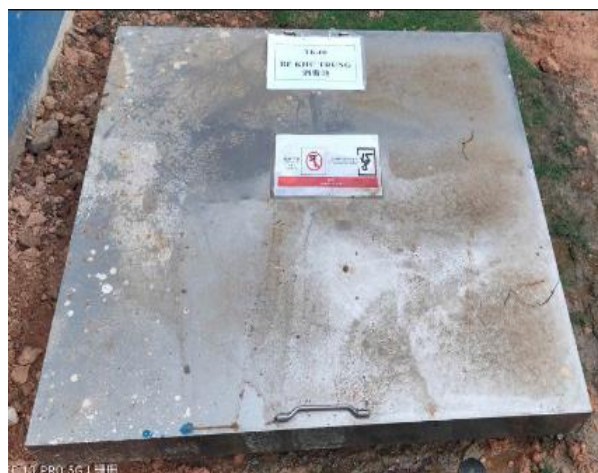
Bể khử trùng
