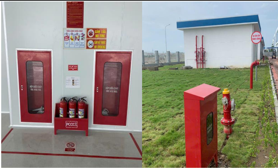
Hình 3.25. Hệ thống phòng cháy chữa cháy tại nhà máy
