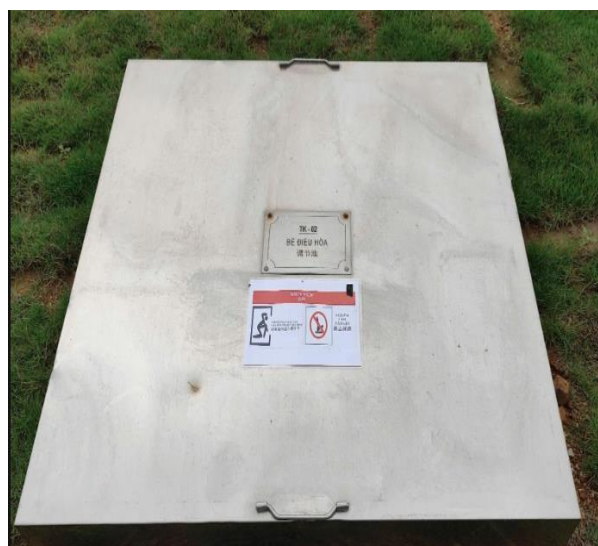
Bể điều hòa
