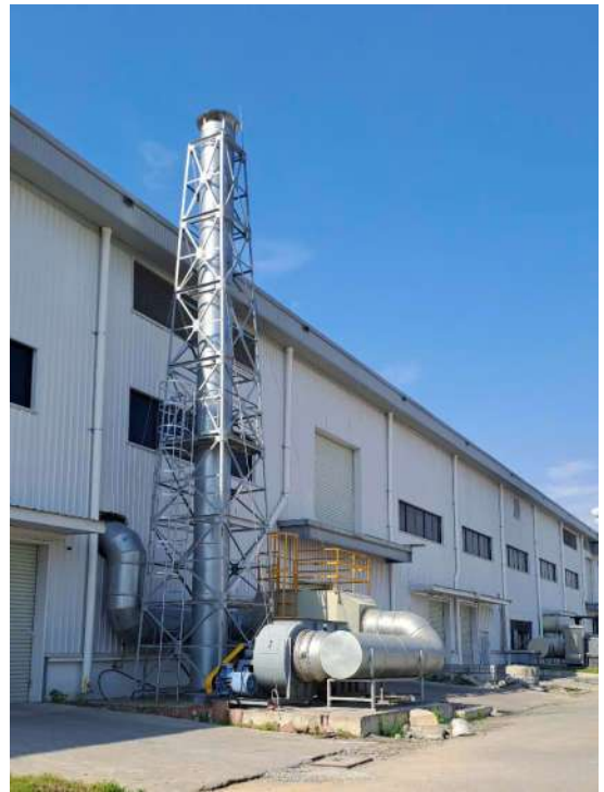
Hệ thống xử lý khí thải từ công đoạn rửa axit, công suất 35.000 m 3 /h
