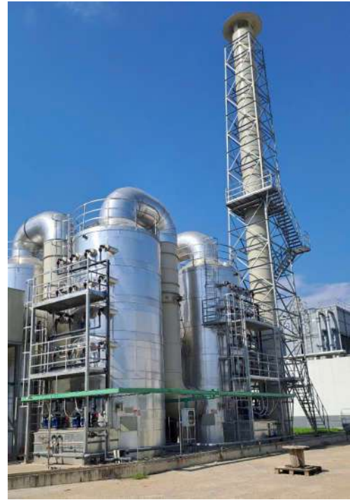
Hệ thống xử lý khí thải từ quá trình dán thanh silic, công suất 133.000 m 3 /h
