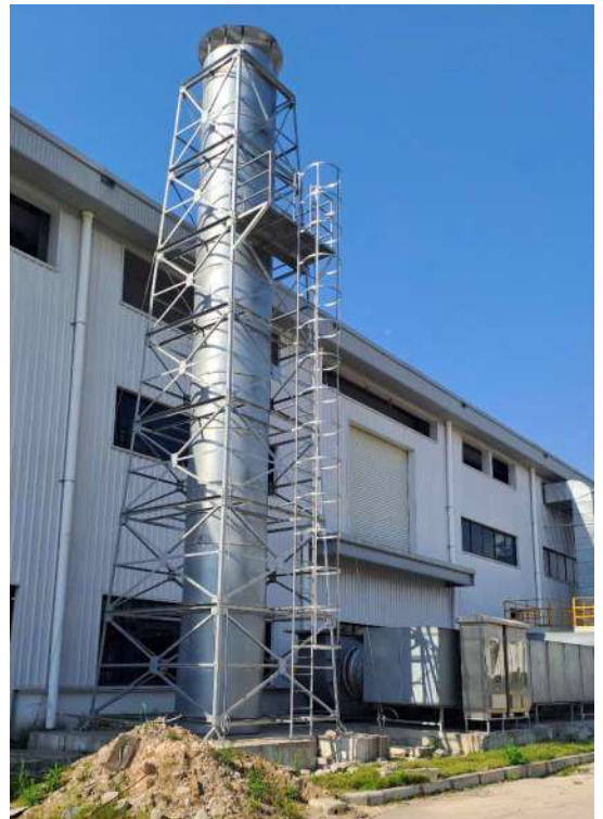
Hệ thống xử lý khí thải từ công đoạn rửa kiềm, công suất 82.000 m 3 /h
