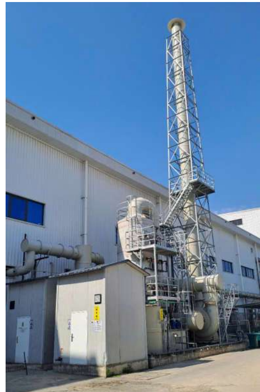
Hệ thống xử lý khí thải từ quá trình dán khử keo, công suất 29.000 m 3 /h
