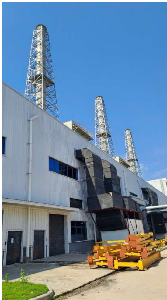
Hệ thống xử lý bụi Silic dạng lọc bụi túi vải số 1, số 2 và số 3, công suất 85.000 m 3 /h/hệ thống
