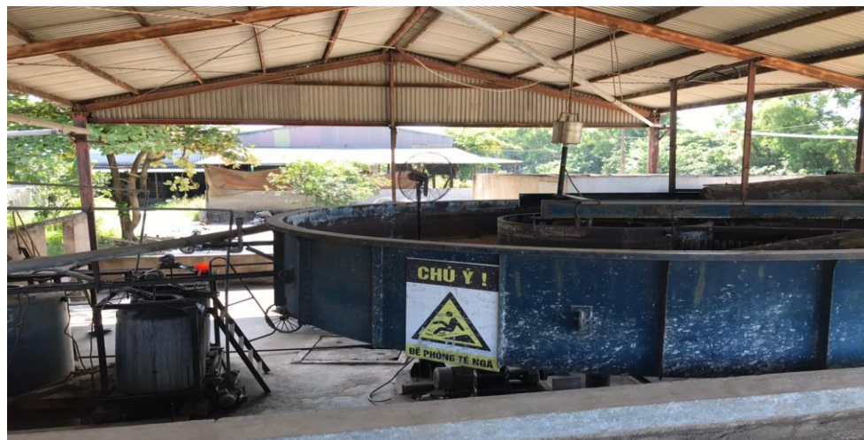
Hình 8: Một số hình ảnh của công trình Hệ thống xử lý nước thải
